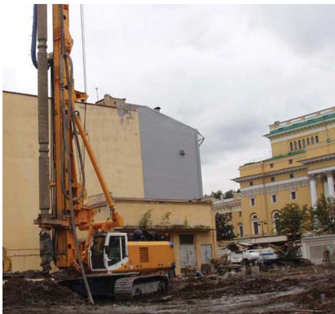
Фото 1. Изготовление свай уплотнения по технологии DDS (площадка строительства гостиницы вблизи Александринского театра, работы ведет ЗАО «Геострой»).
